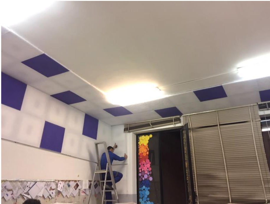
Fig. 21 Particolare dell'aula al primo piano dell'IC di Pellezzano - Plesso Scuola Primaria sito in via della Quercia a Capezzano (Pellezzano – SA) a valle dell'intervento
