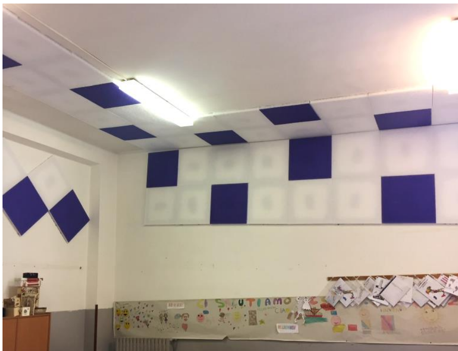
Fig. 20 Particolare dell'aula al primo piano dell'IC di Pellezzano - Plesso Scuola Primaria sito in via della Quercia a Capezzano (Pellezzano – SA) a valle dell'intervento
